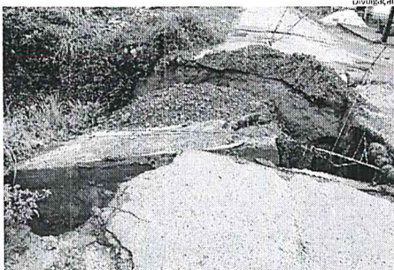
Parte da ponte caiu, prejudicando a vida de moradores do bairro
