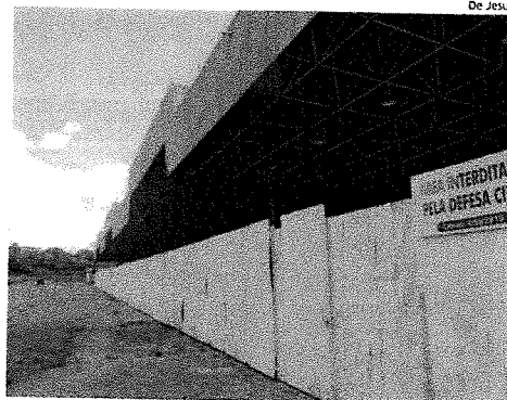
Parte do Terminal Rodoviário de São Luís permanece interdito
