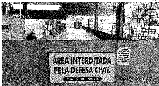
Parte da área do Terminal Rodoviário de São Luís está interdita e necessita de obras emergenciais
