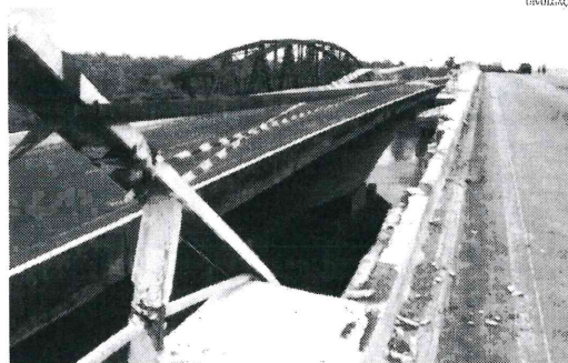
A PONTE ESTÁ COM ESTRUTURA COMPROMETIDA DESDE DO MÊS DE OUTUBRO DE 2019
