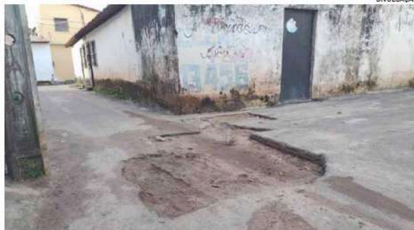
Serviço da Caema, deixado pela metade, tem provocado transtornos aos moradores do Túnel do Sacavém
