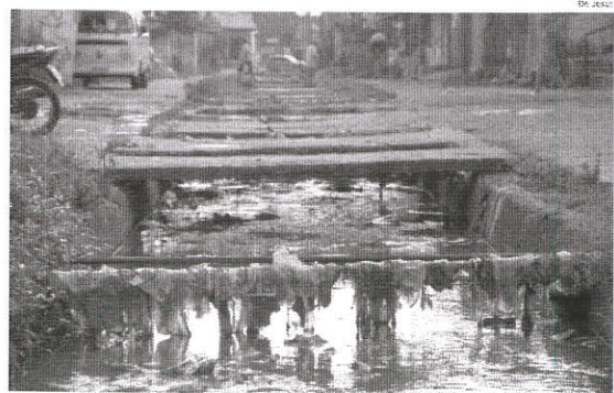
Moradores jogam lixo na vala na Rua da Felicidade, via sem coleta de esgoto nem drenagem da água de chuva
