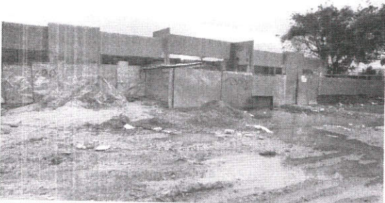
Obra da principal creche da Cidade Operária não está em execução; serviços estão parados e sem previsão
