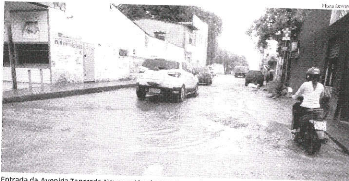
Entrada da Avenida Tancredo Neves está esburacada, e a chuva esconde profundidade das crateras
