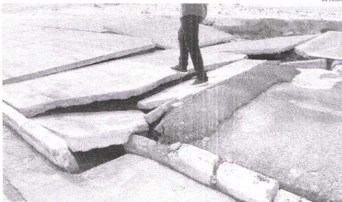
Calçadão no prolongamento da Avenida Litorânea está danificado e provoca perigo para quem transita
