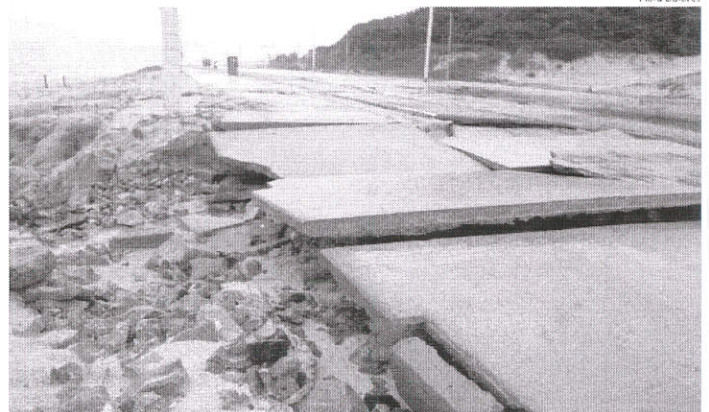
Sinais de rachaduras começaram a aparecer há cerca de 15 dias, segundo pessoas que trabalham por lá
