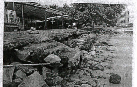
Na Ponta d'Areia, os comerciantes reclamam dos prejuízos causados pelos problemas estruturais
