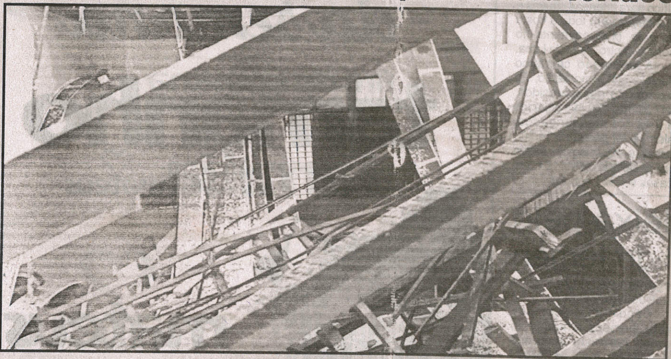
Estrutura do teto veio a baixo por causa das últimas chuvas registradas na cidade
