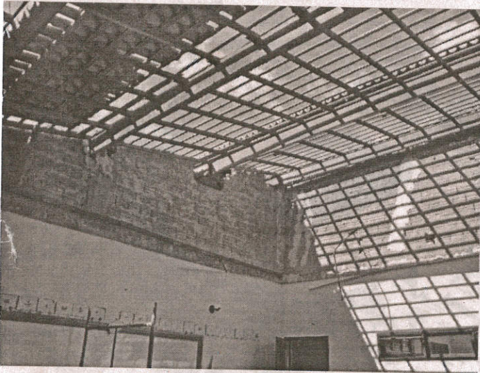
O forro de praticamente toda a escola precisou ser retirado para que a inspeção visual do madeiramento
