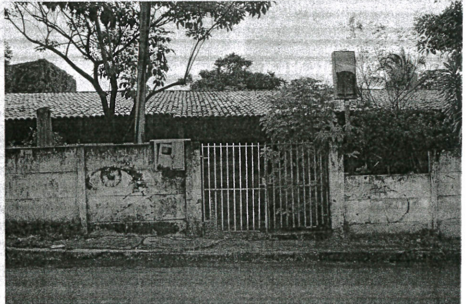
Localizado na Rua Travessa do Dirceu, no Diamante, o CAJ precisa de atenção urgente
