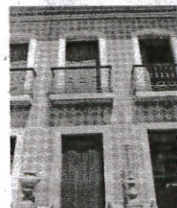
OLHADO COM FIXAÇÃO, SURGEM AS FALHAS EM TODA A FACHADA DO HISTÓRICO MOTO BAR
