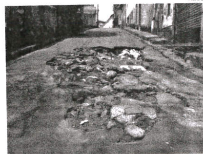
Buraco dificulta tráfego de veículos na Rua da Inveja, no Centro
