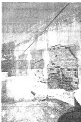
Buraco feito no muro foi fechado na noite da explosão
