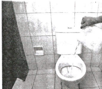
Descarga do banheiro feminino está quebrada e sanitário, desgastado
