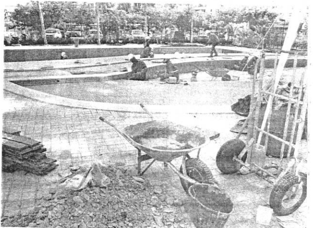
Durante a vistoria, foi possível ver operários trabalhando nas piscinas do condomínio, interditadas por duas vezes
