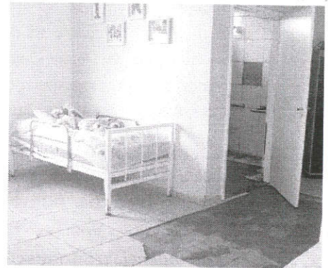
Vistoria em maio constatou problemas como falta de infraestrutura
