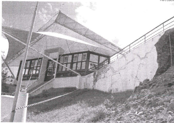
Com a queda de parte da estrutura da área externa da capela, quem frequenta o local está preocupado
