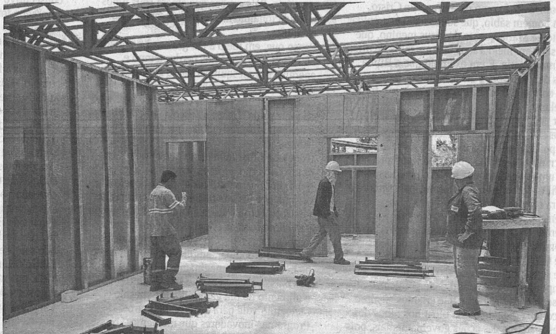
Operários trabalham nas obras dos centros de nefrologia e hemodiálise do Estado, que atenderão pacientes com insuficiência renal aguda e crônica
