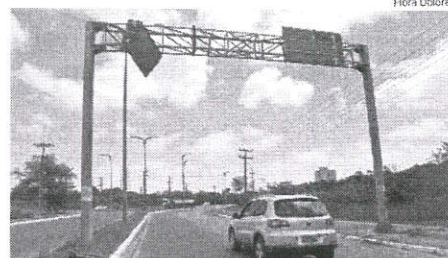
Placa na Avenida Ferreira Gullar prestes cair a qualquer momento
