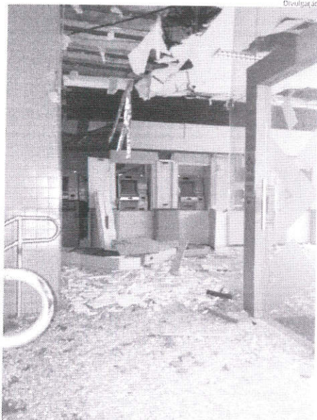
Agência bancária, em Codó, parcialmente destruída com a explosão
