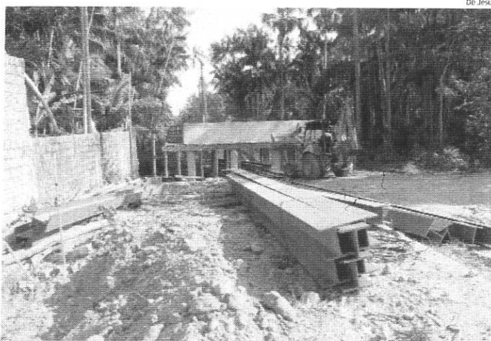
A Ponte Pátio Norte deverá ser entregue apenas em fevereiro do ano que vem, informa a Sinfra
