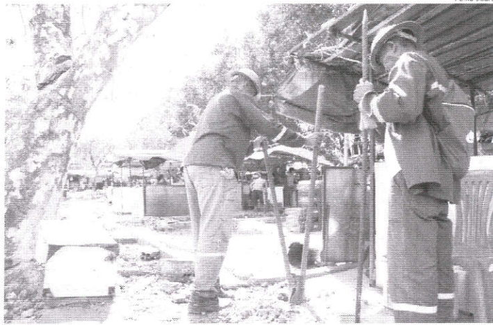
Operários da Ducol iniciaram ontem a montagem da estrutura do canteiro de obras na Praça Deodoro
