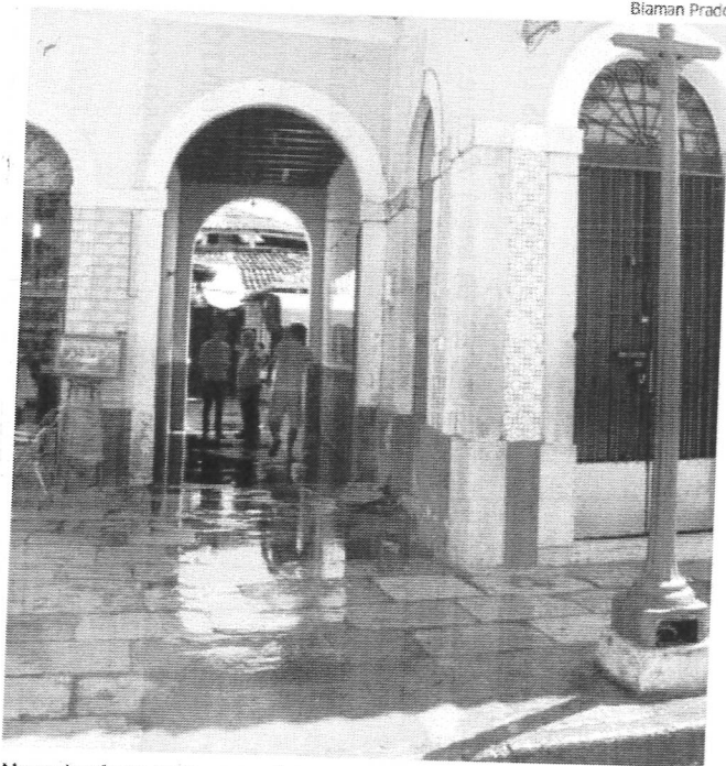
No corte, algum erro causou desperdício e alagamento na entrada da feira
