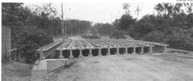
Após denúncia de que obra estava abandonada, serviço foi retomado e vigas de concreto colocadas no local
