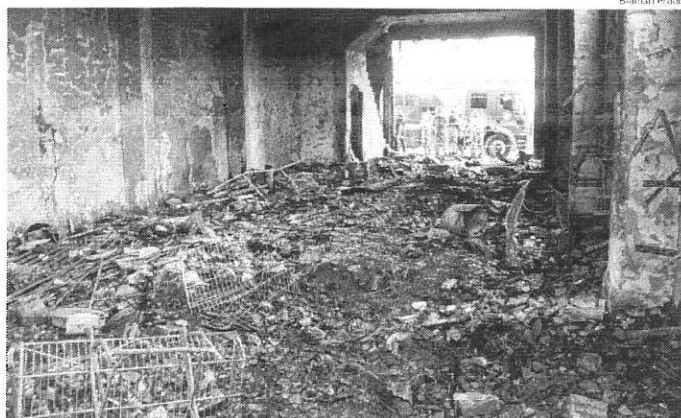
Loja de fogos na rua Riachuelo que ficou destruída pela explosão ocorrida na madrugada de ontem
