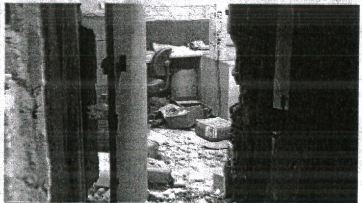
Agência bancária ficou parcialmente destruída com a força da explosão
