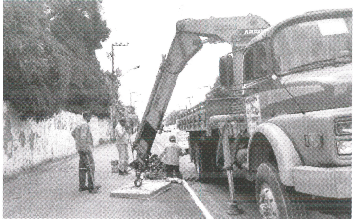
Durante a desobstrução das galerias, a prefeitura remove os resíduos acumulados de descarte irregular
