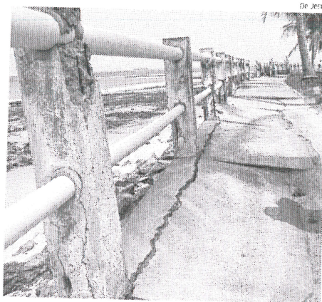
Rachaduras e piso danificado colocam em risco a vida das pessoas
