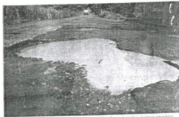
A Avenida do Matadouro é uma das vias prejudicadas pela infraestrutura precária
