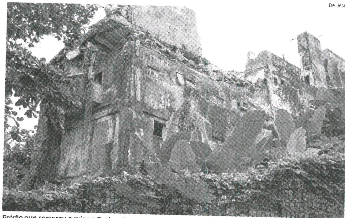
Prédio que começou a ruir no Centro, deve ser demolido nas próximas semanas por ordem da Defesa Civil
