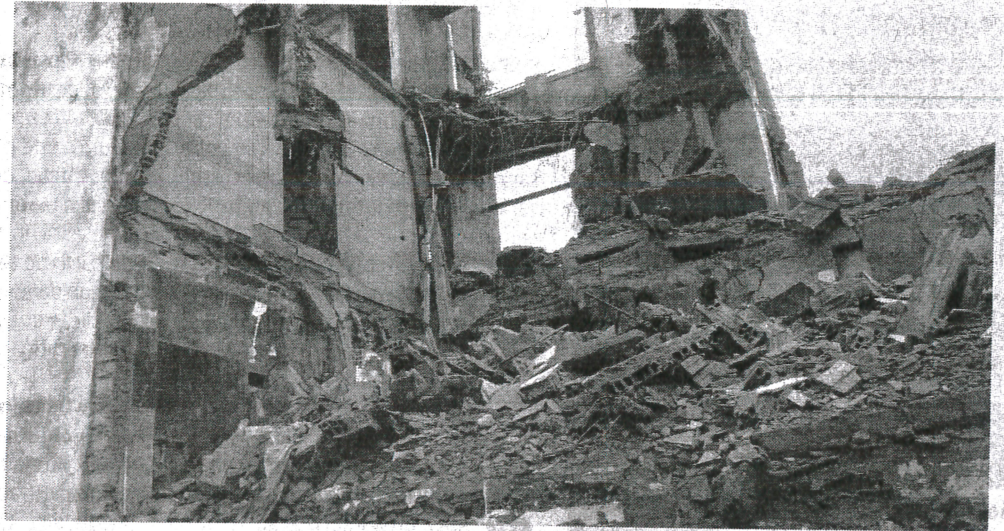
Casarão vizinho à Superintendência de Homicídios desabou na Rua Celso Magalhães, no Centro de São Luís
