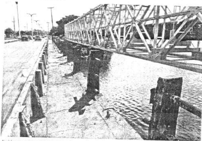
Problemas na estrutura que contempla o complexo da barragem também são motivos de preocupação para quem transita pelo local
