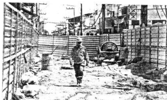
Os comerciantes da Rua Grande dizem que a demora se dá pelo número reduzido de operários no canteiro de obras; foi dito que há dias nos quais apenas um trabalhador é visto no local
