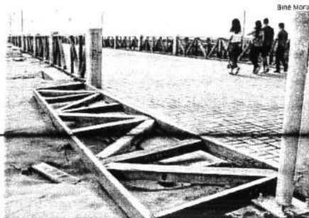
Estrutura de madeira está danificada e visitantes reclamam
