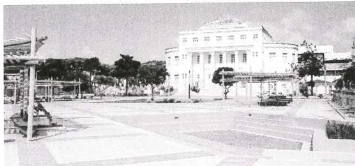
Na Praça do Pantheon a obra segue para a reta final, com instalação dos bustos de personalidades
