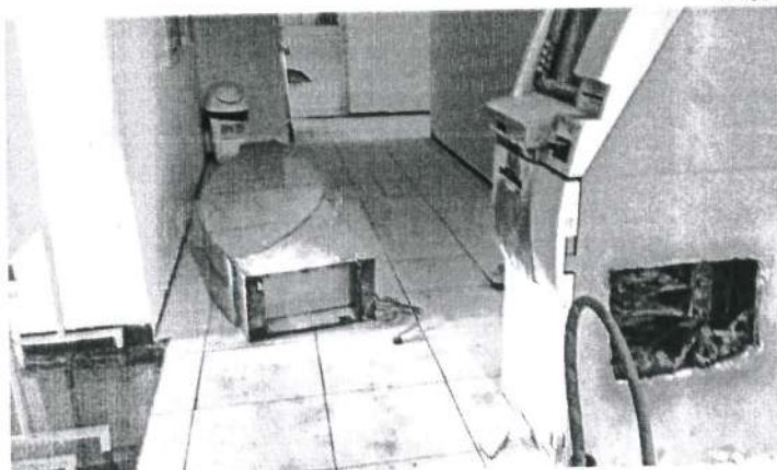
Caixa eletrônico instalado em prédio da Caema, em São Luís, ficou danificado após ação dos criminosos
