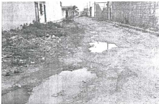
Entre os problemas está a infraestrutura precária das ruas do Residencial Estrela d'Alva
