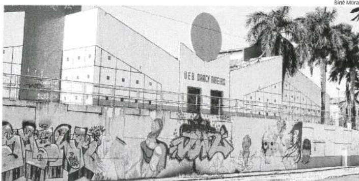
UEB Darcy Ribeiro, na Avenida dos Africanos, necessita de ampla reforma para garantir segurança estrutural
