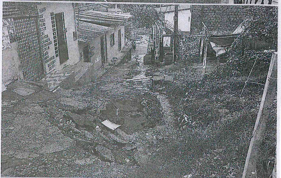
O rompimento da tubulação 'rasgou' a rua ao meio e deixou os moradores preocupados, pelo risco de desabamento de algumas residências
