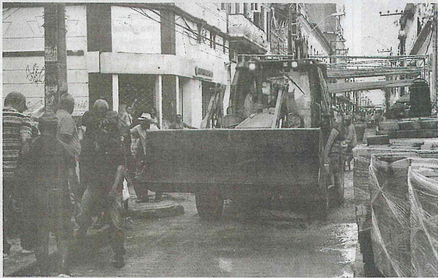
Construtora foi notificada para sinalizar adequadamente o canteiro de obras, a fim de garantir a segurança de quem trafega pela Rua Grande
