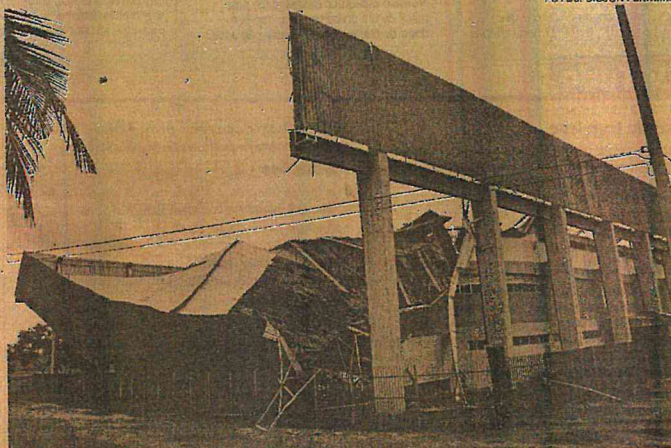
Parte do telhado do Castelinho não resistiu à força da forte chuva e de ventania, ocorridas no início da tarde de quarta-feira (6), e foi ao chão
