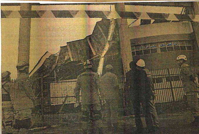
Homens do Corpo de Bombeiros e do Icrim realizaram vistoria ontem na estrutura desabada, a fim de verificar as possíveis causas
