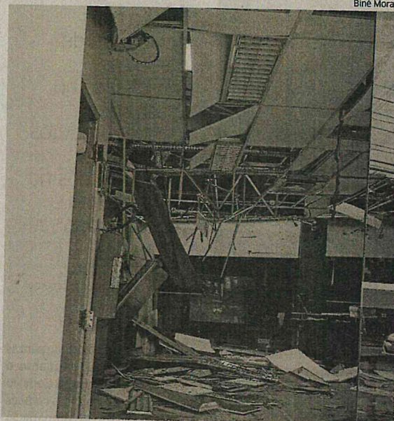
Agência do BB da Santos Dumont ficou destruída com a explosão
