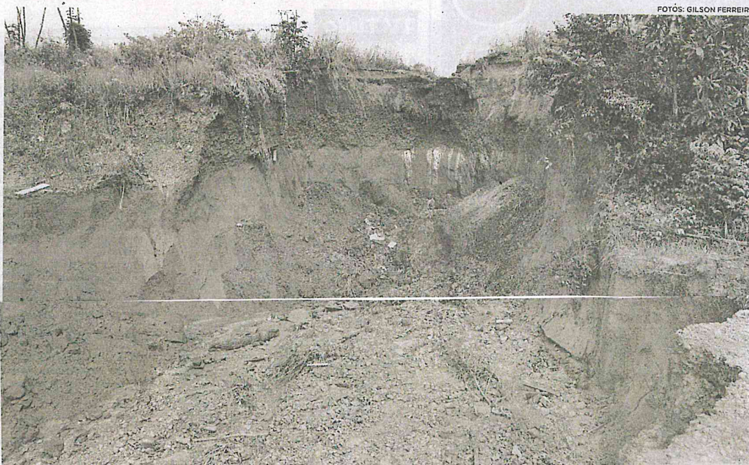
Nova cratera se formou no Residencial Ribeira, após abertura de valas para escoamento da água durante trabalhos em ruas do lugar
