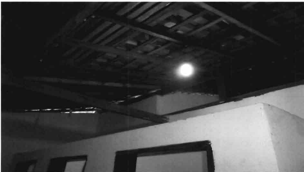
Ilustração 14: Teto do banheiro
