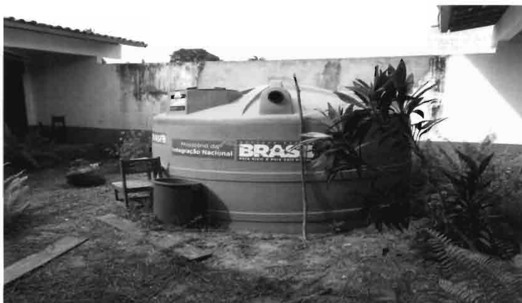
Ilustração 6: Cisterna para armazenamento de água da chuva
