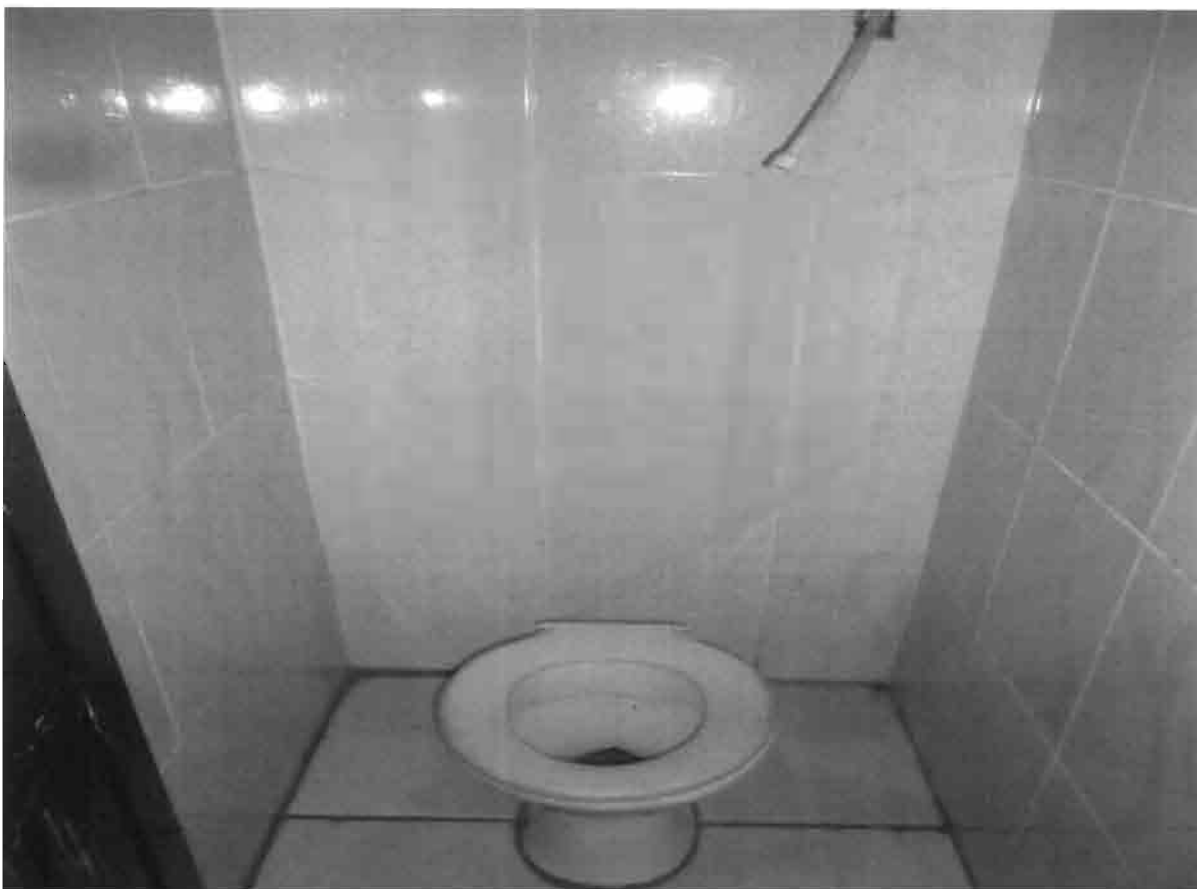
Ilustração 13: Vaso sanitário sem sistema de descarga
